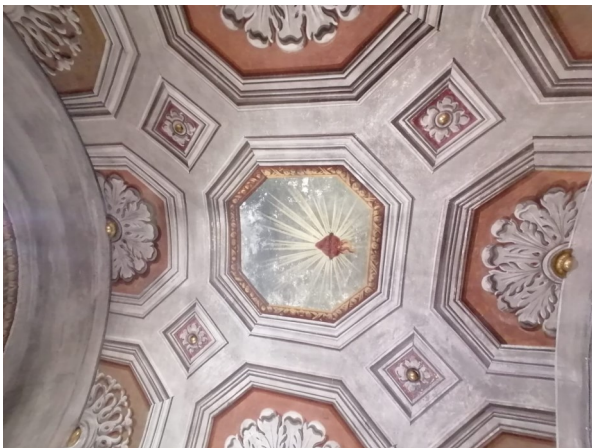
Particolare della cappella della Madonna delle Grazie. Il degrado e il risanamento.
